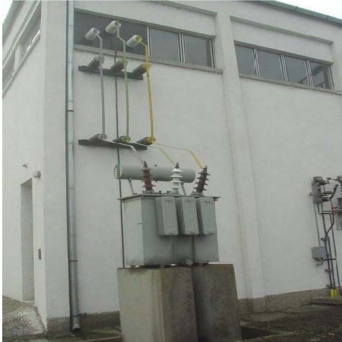
Трансформатор за домашна потреба 35/0,4 kV
